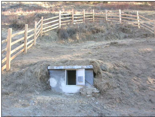
Photo 11 : Aspect extérieur du captage- Bassins (Source : HYDRETTUES le 25 nov. 2011)
