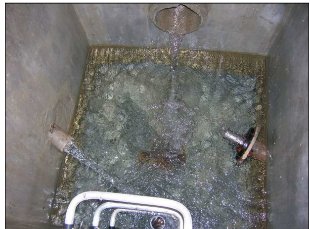
Photo 6 : Intérieur de l'édicule de captage – Mounal 3 (Source : HYDRETTUES le 2 sept. 2012)
