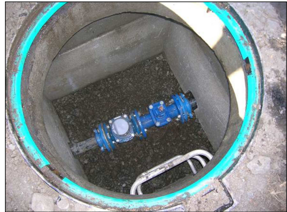
Photo 14 : Intérieur du regard abritant le compteur (Source : HYDRETTUES le 25 nov. 2011)
