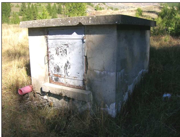
Photo 9 : Aspect extérieur du captage – Chabas (Source : HYDRETTUES le 30 oct. 2013)
