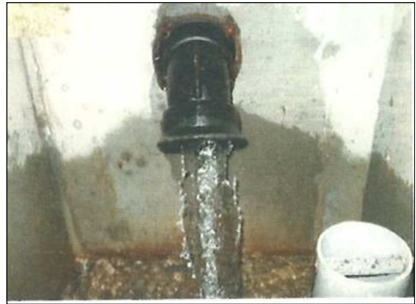
Photo 8 : Intérieur de l'édicule de captage – Clôt Besseys (Source : SDAEP 2003)
